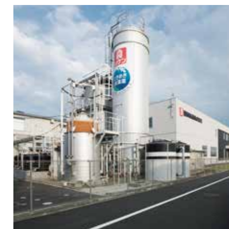
排水処理施設
