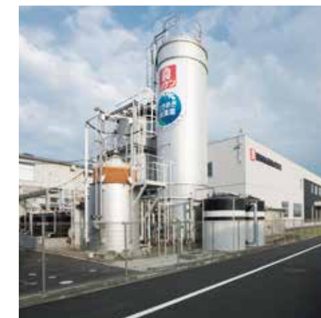
排水処理施設
